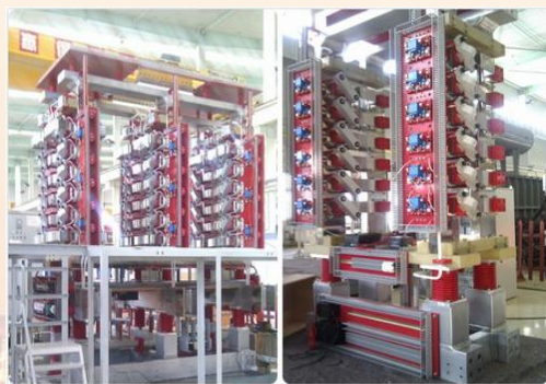
整流桥及外旁通设备
